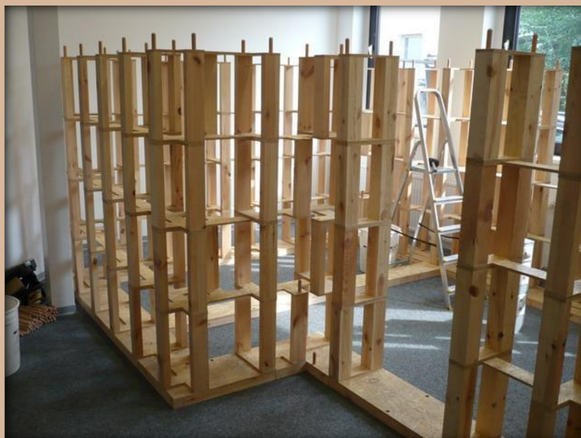
Rysunek 3 Ściana bez wypełnienia materiałem termoizolacyjnym - zdjęcia z testów wytrzymałościowych w Instytucie HSW (Niemcy)
